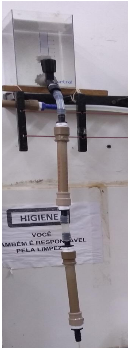
Figura 2 - Tratamento de efluente do proceso de coagulação/floculação através de filtro de areia e carvão ativado
